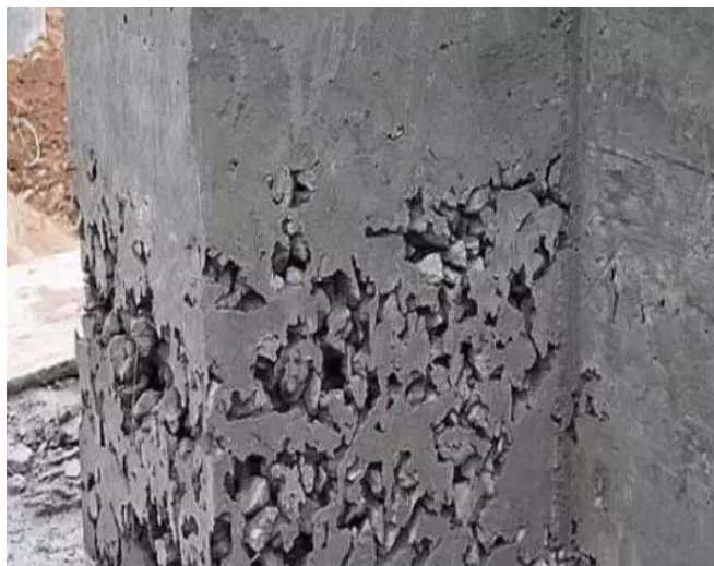
图1 混凝土蜂窝麻面图
