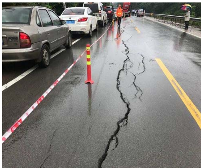
图一 路面裂缝
