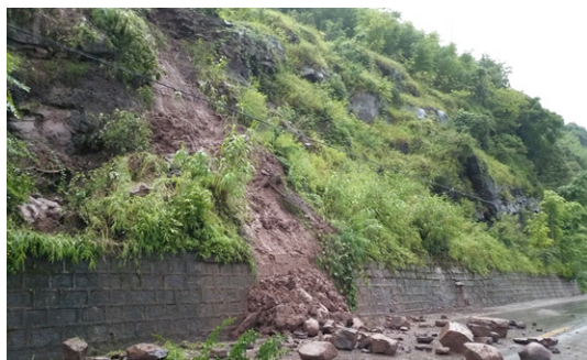
图二 公路滑坡现场图
