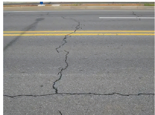
图一 路面龟裂现场图
