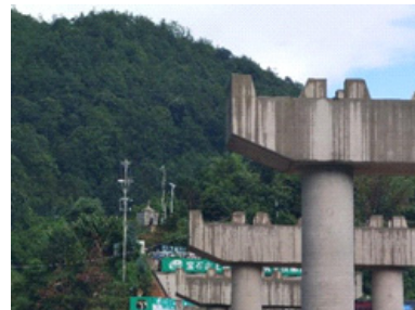
图 1 隧道外部偏压情况
