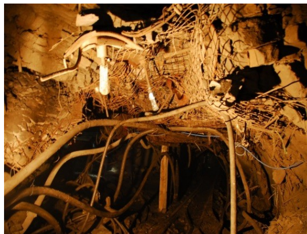
图 1 巷道破坏情况
