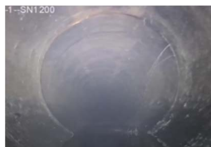
接口地下水涌漏
