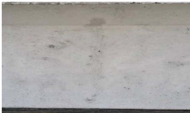
图1 安公高速3标T梁收缩裂缝
