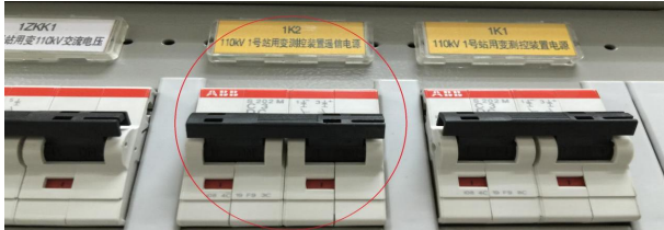
图6:1K2 110kV 1号站用变测控装置遥信电源空开
