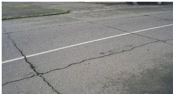
图2 路基路面裂缝
