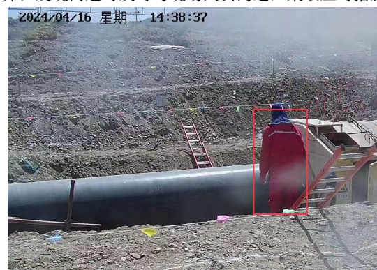
图2 机组作业人员存在坠落风险
